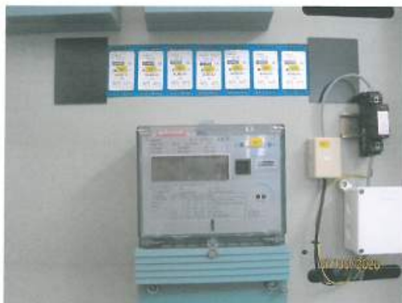
Fotos 16 – Sistema de telecontagem.
